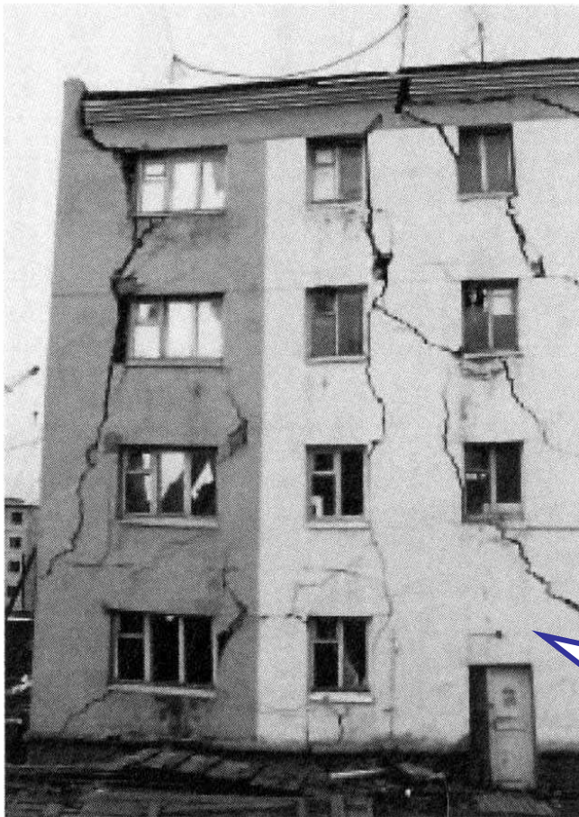
図6.8 永久凍土の上に直接建てたシベリアのアパートが崩壊した例（ACIAレポート）。
